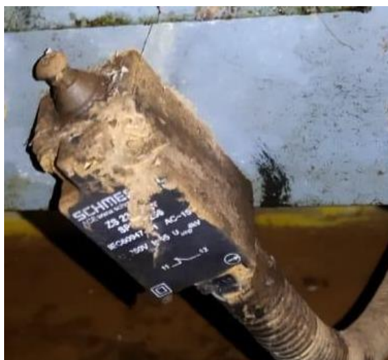
Exemplo de contato elétrico da polia tensora de elevador danificado
