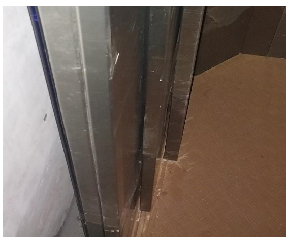
Corrediças de porta de cabina ficaram submersas em água suja
