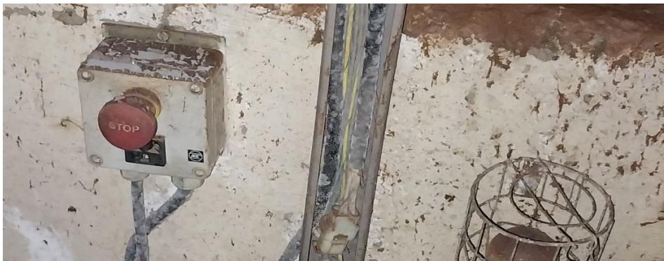
Caixa de fundo de poço do elevador danificada, ficou submersa na água.
