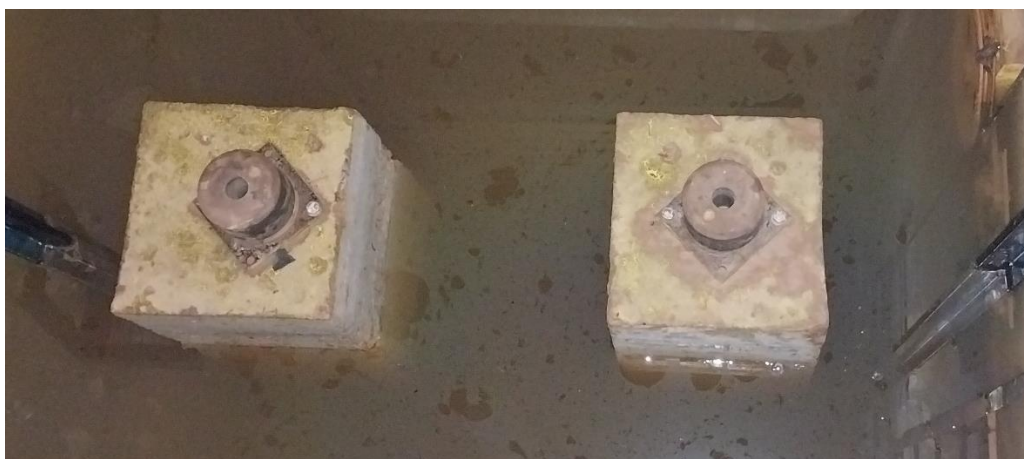
Buffers de cabina e contrapeso do elevador danificados
