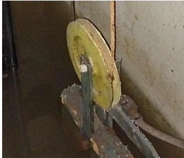
Polia tensora ainda submersa na água
