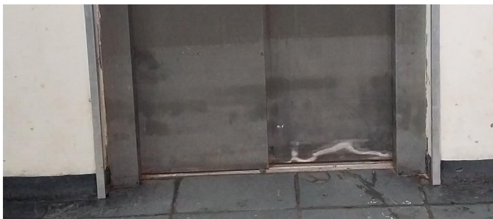
Corrediças de porta de pavimento ficaram submersas em água suja
