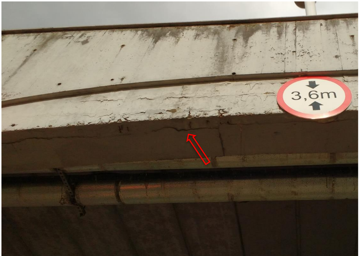
Figura 10-8: Detalhe das fissuras na face lateral e inferior do trecho curvo das vigas (longarinas).
