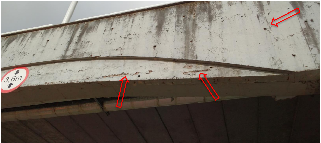
Figura 10-7: Detalhe das fissuras nas vigas (longarinas) com exposição de armaduras em alguns pontos.
