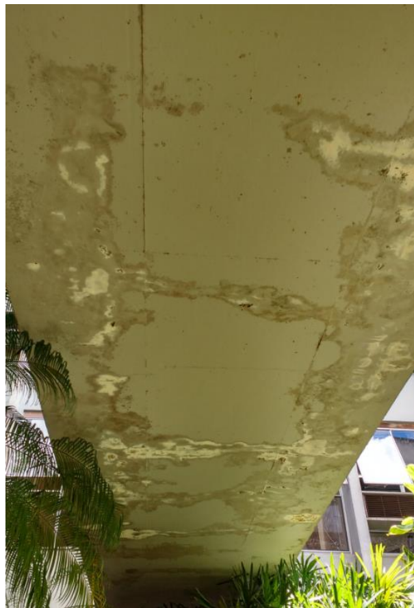
Figura 15-4: eflorescências na laje (face inferior) da passarela interna.
