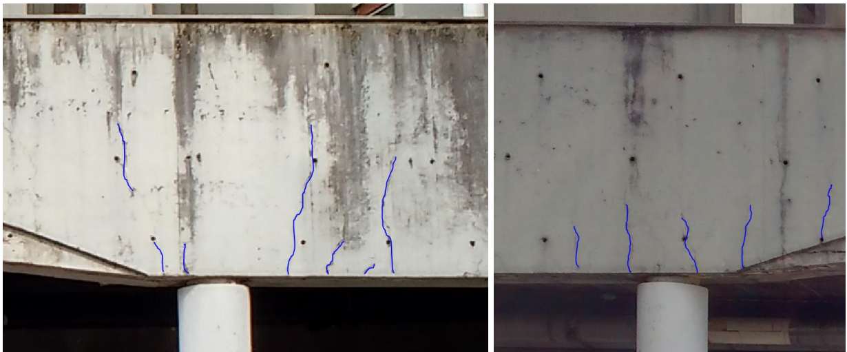
Figura 10-10: ampliação da região próxima aos pilares com fissuras destacadas.
