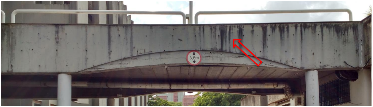
Figura 10-9: manchas no concreto.
