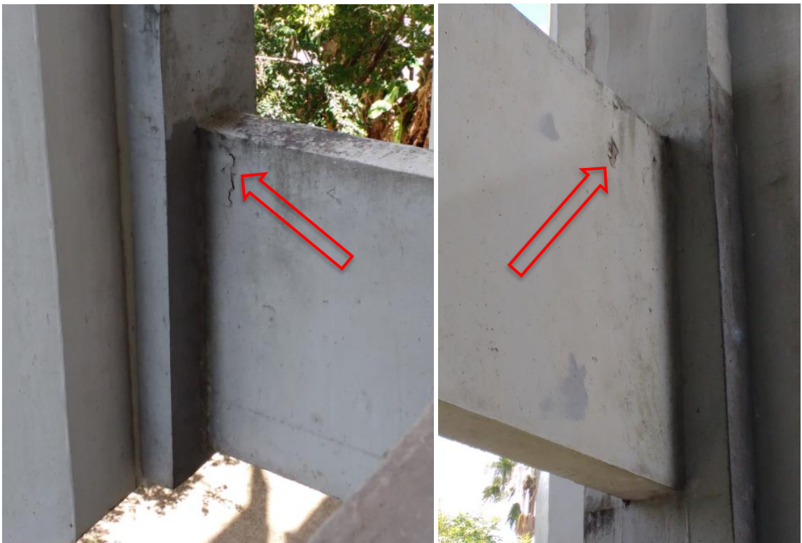
Figura 8-5: fissuras nas vigas em balanço das fachadas.
