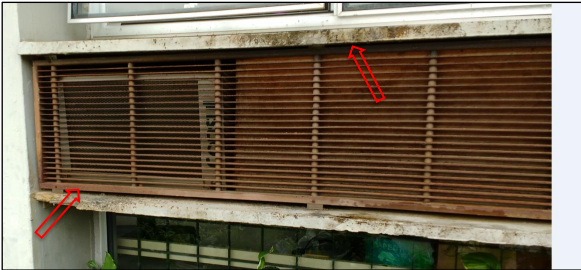
Figura 7-2: laje inferior apresentando deslocamento do concreto e laje superior com manchas provocadas pelo gotejamento d'água.
