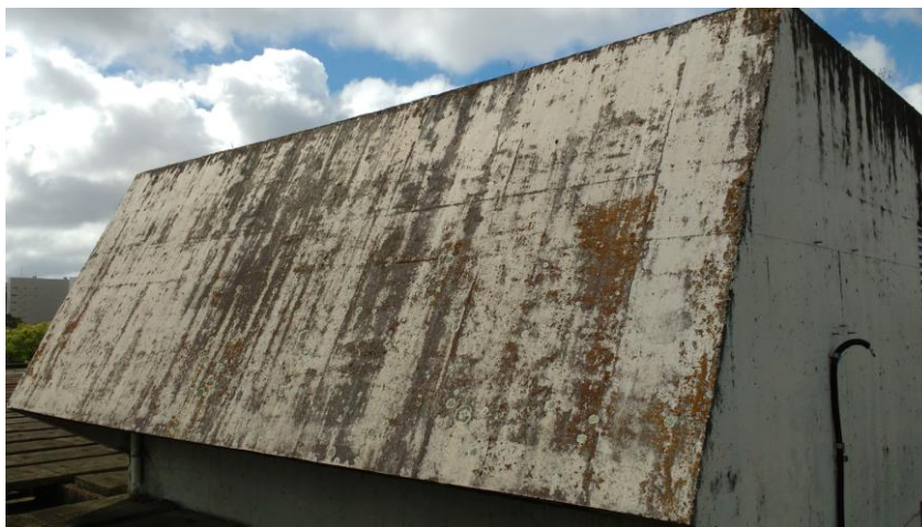
Figura 15-2: manchas nas paredes de fechamento das casas de máquina.
