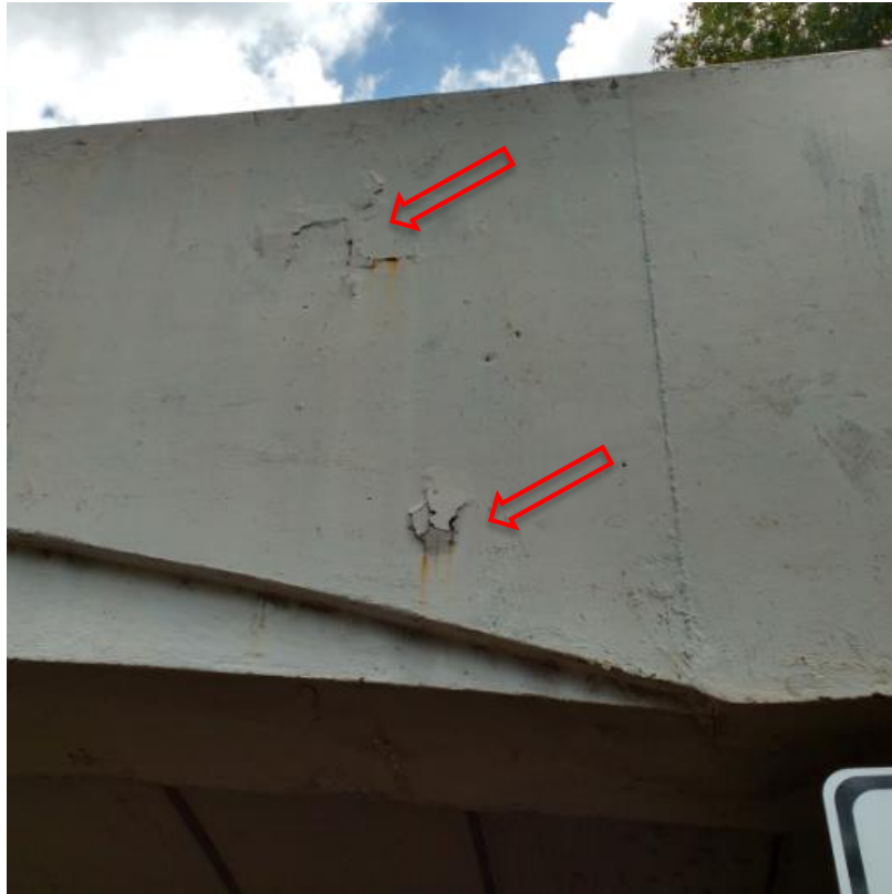
Figura 10-3: início de corrosão nas armaduras com deslocamento de concreto.
