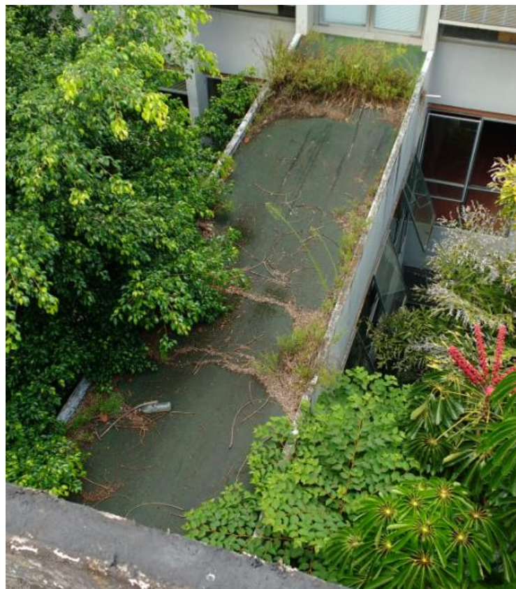
Figura 9-6: laje da passarela sem cobertura vegetal.
