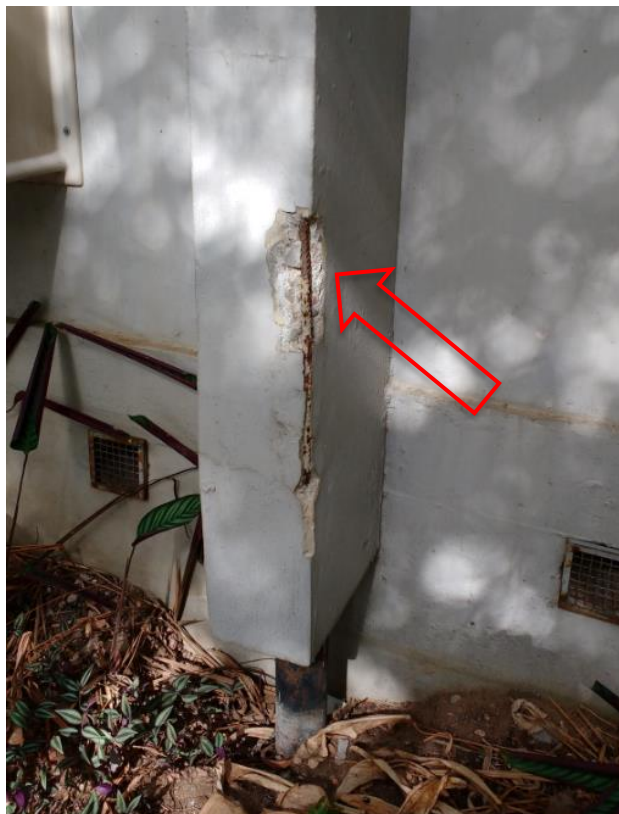
Figura 8-3: concreto disgregado e armadura exposta em um elemento vertical (não estrutural) de fachada.
