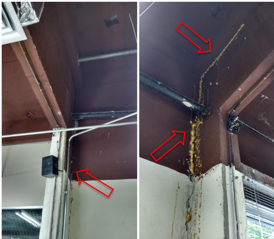
Figura 14-3: Junta de dilatação (interna) com alvenaria e reboco cobrindo a abertura.
