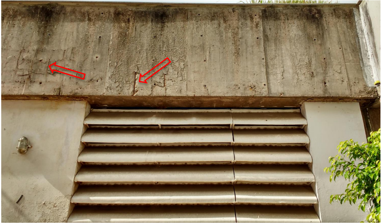
Figura 12-2: fissuras e deslocamento do concreto; armaduras expostas.
