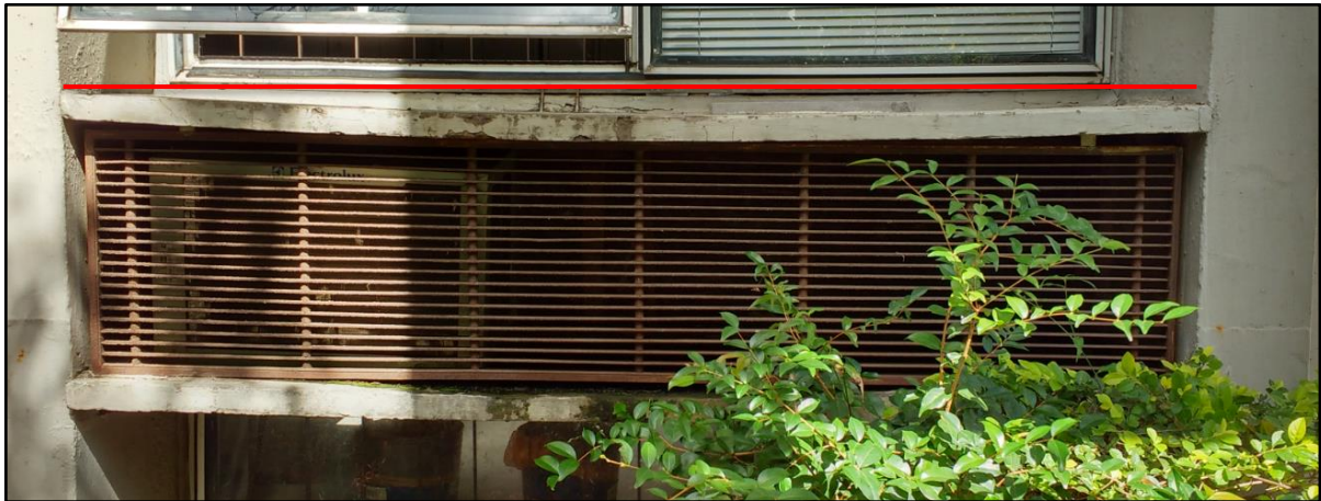
Figura 7-5: linhas de referência para evidenciar a deformação excessiva das lajes.
