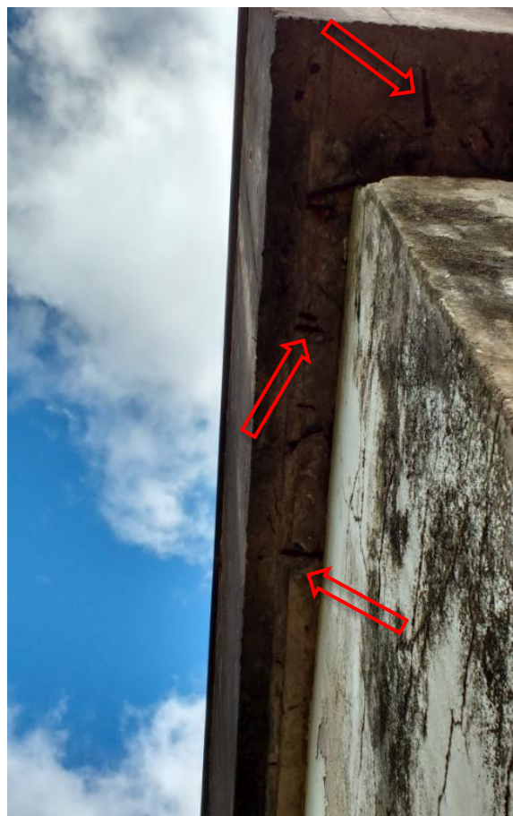
Figura 12-5: vista inferior do fundo da viga (platibanda) com armaduras expostas.
