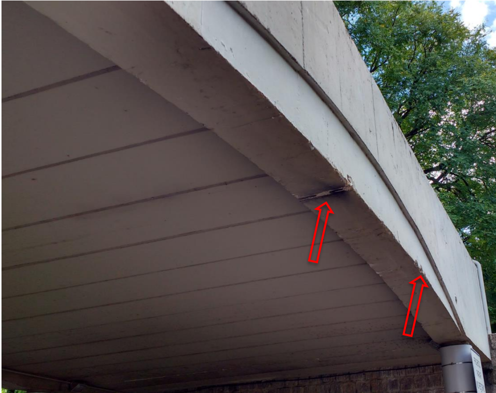
Figura 10-5: danos na face inferior da viga com exposição de armaduras em alguns pontos.
