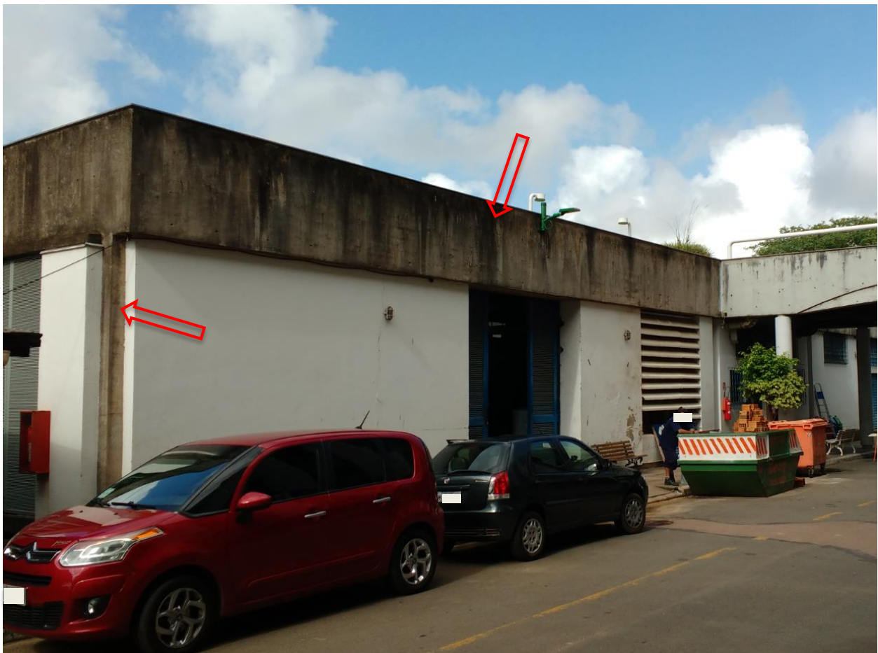
Figura 12-1: manchas nas vigas e pilares.
