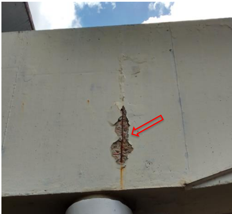
Figura 10-4: deslocamento no concreto e armadura exposta (estribo).
