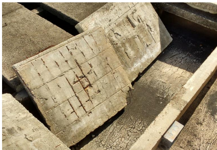
Figura 17-2: placas pré-moldadas apresentando desgaste do concreto e armadura exposta.
