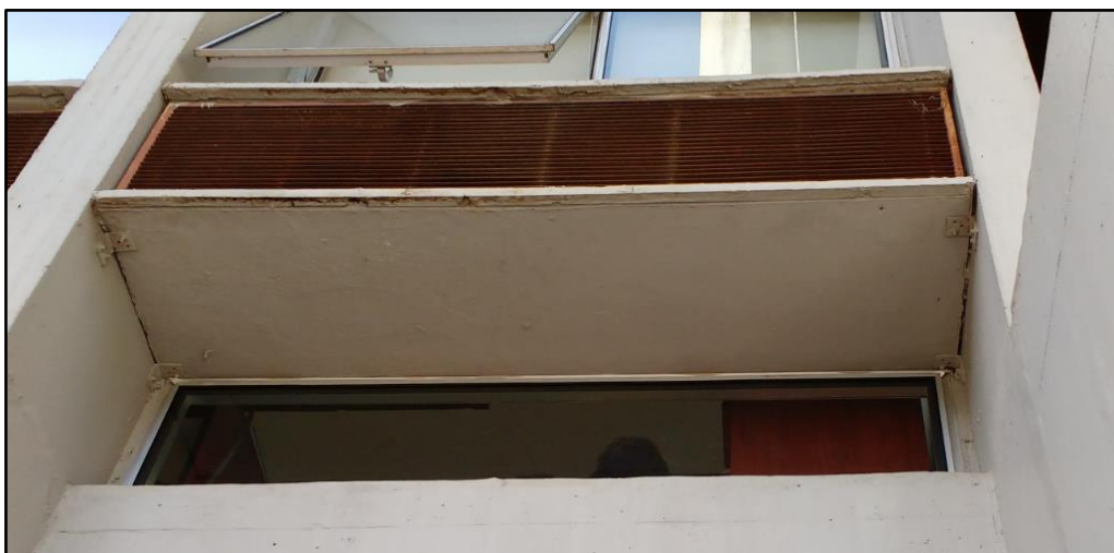
Figura 7-1: Lajes de concreto armado para instalação e proteção de aparelhos de ar-condicionado.
