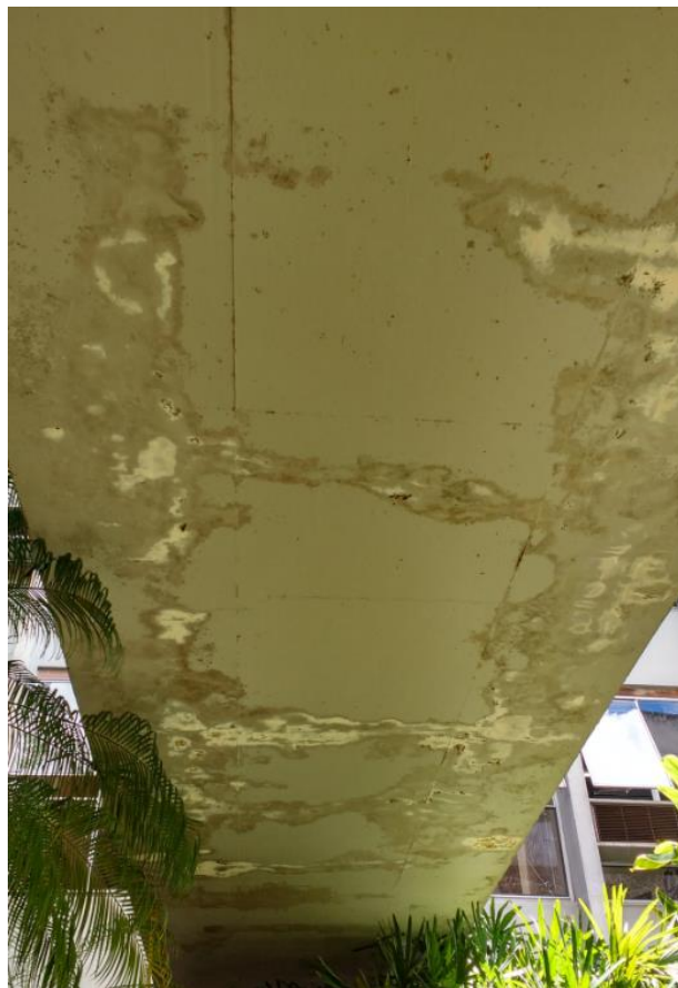
Figura 9-4: eflorescências na laje (face inferior) da passarela interna.
