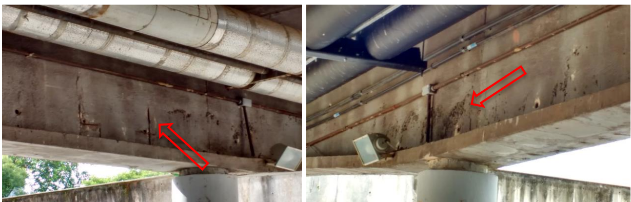
Figura 10-11: armadura exposta e falhas de concretagem na face interna das longarinas.
