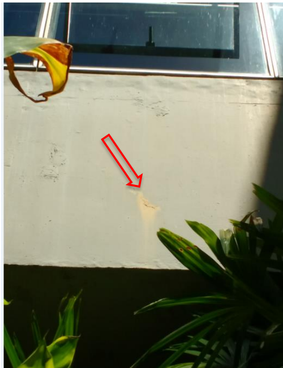
Figura 9-2: fissuras e mancha na face externa das vigas.
