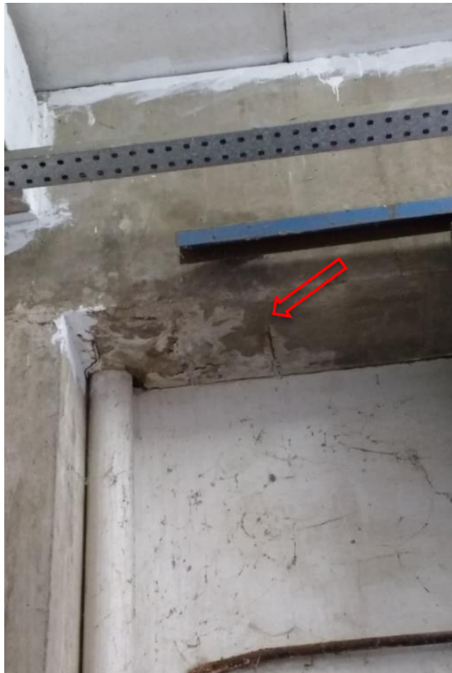
Figura 12-3: armaduras expostas na face inferior de uma viga interna.
