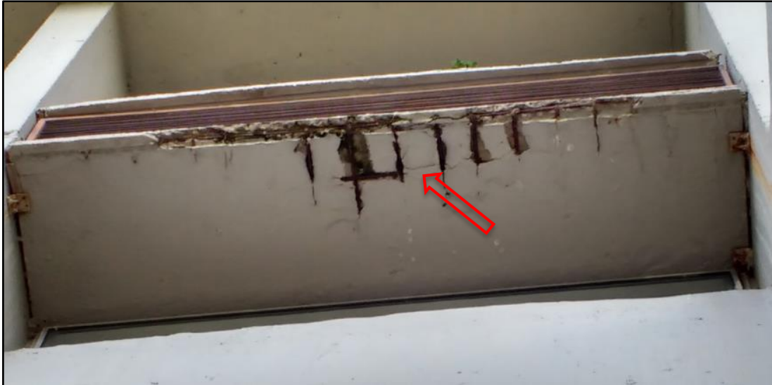
Figura 7-4: danos na borda e na face inferior da laje decorrentes de processo corrosivo.
