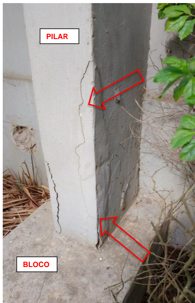
Figura 8-1: danos comumente encontrados nos pilares na região próxima ao bloco de fundação.
