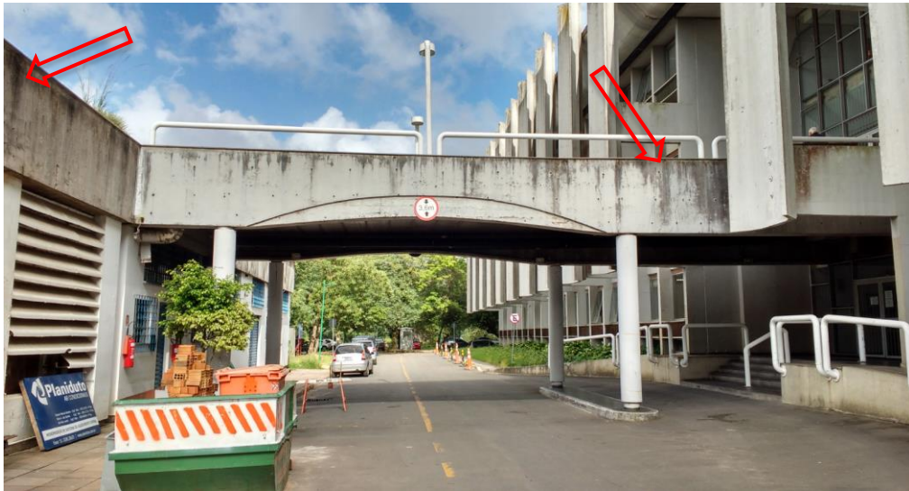
Figura 15-3: manchas na platibanda do prédio de utilidades e na passarela.
