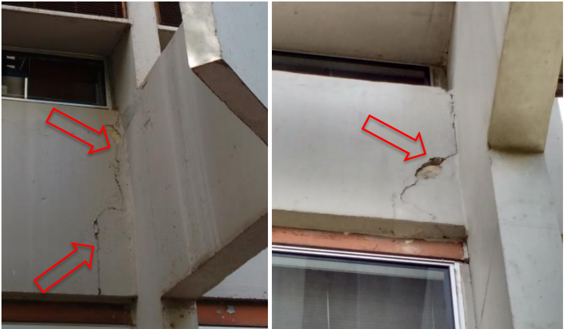
Figura 14-2: Junta de dilatação (externa) com aplicação de argamassa sobre a abertura, levando ao surgimento de fissuras no revestimento.
