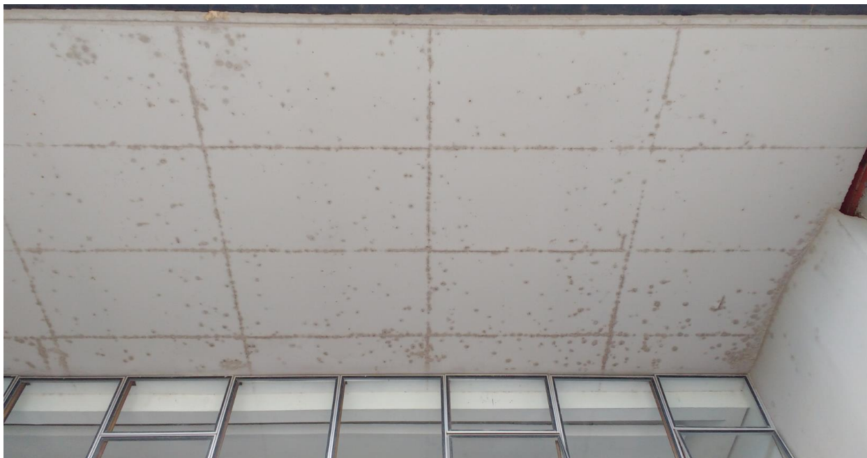
Figura 15-5: manchas na laje de cobertura do acesso (2º pavimento).
