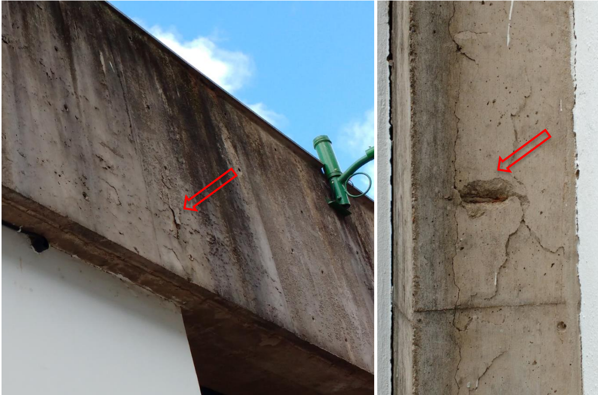
Figura 12-4: regiões com concreto disgregado e armadura exposta.
