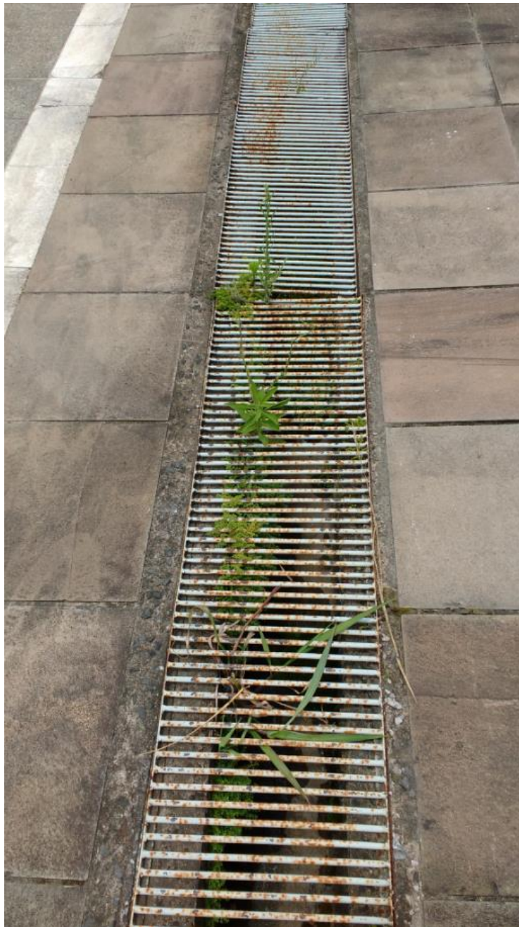
Figura 13-1: Calha assoreada, onde já podem ser vistas pequenas plantas no seu interior, reduzindo a seção de escoamento.
