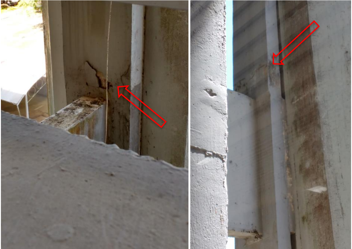
Figura 8-4: deslocamento e fissuras pontuais nos pilares onde os brises são fixados lateralmente.
