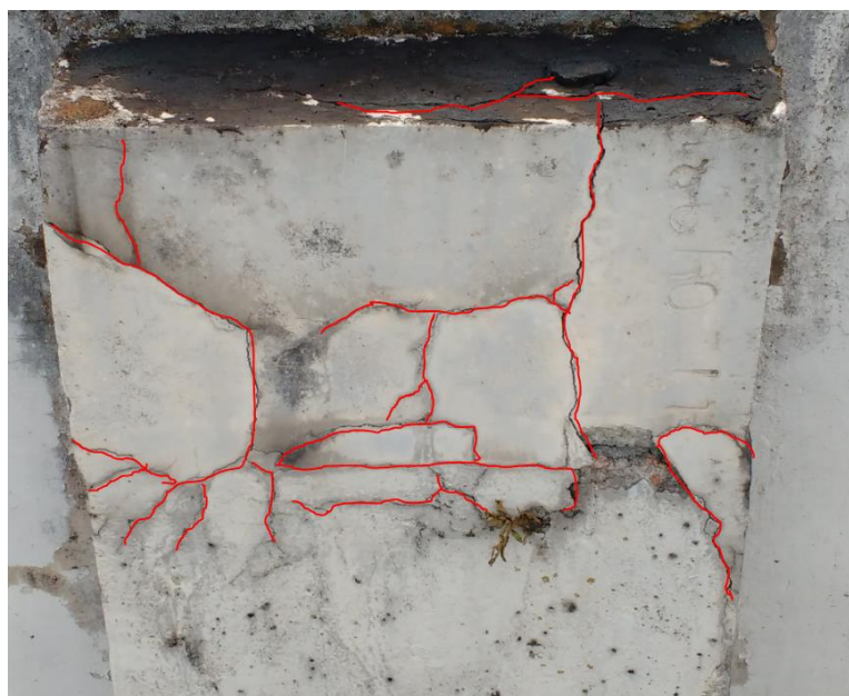
Figura 16-5: fissuras no console no BRISE 10.
