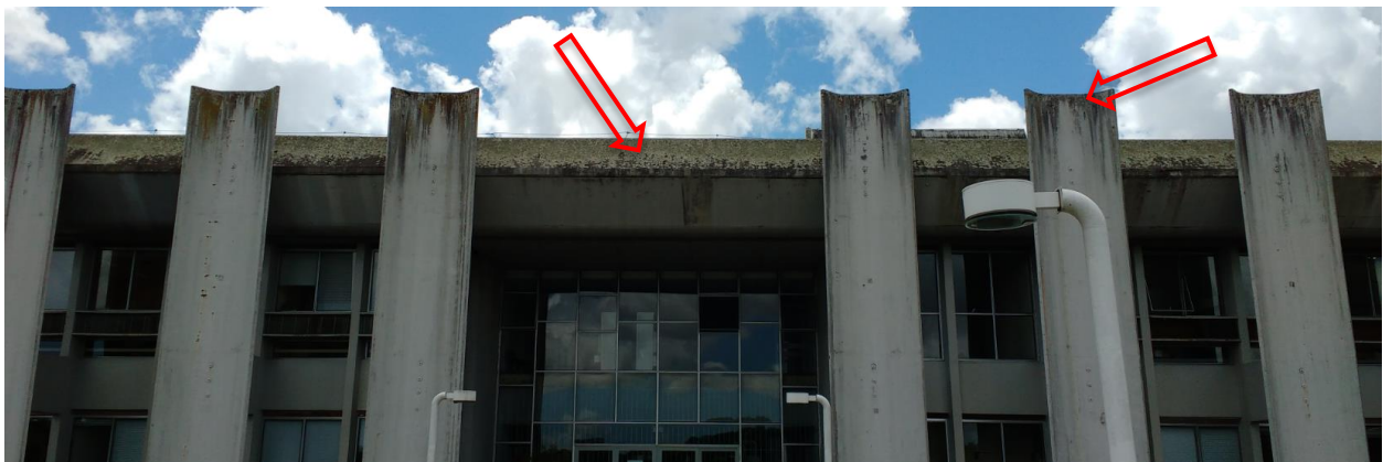
Figura 15-1: manchas devido à ação do tempo na platibanda e nos brises.
