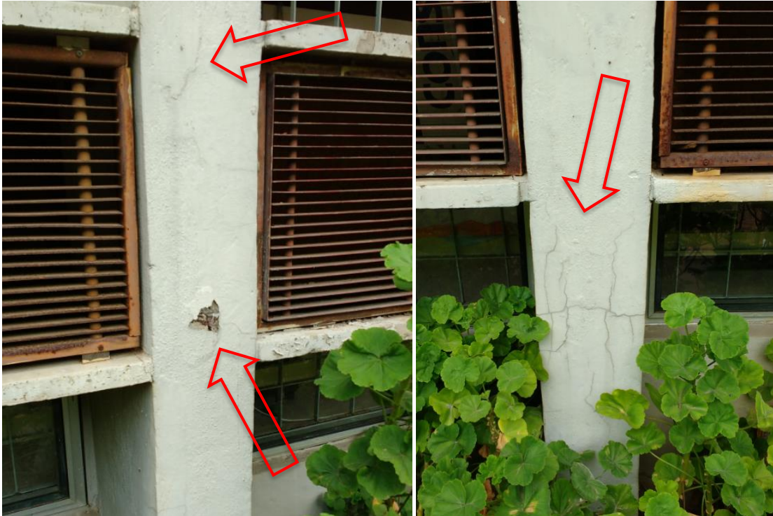
Figura 8-2: danos isolados encontrados em alguns pilares: a) armadura exposta e b) fissuras.
