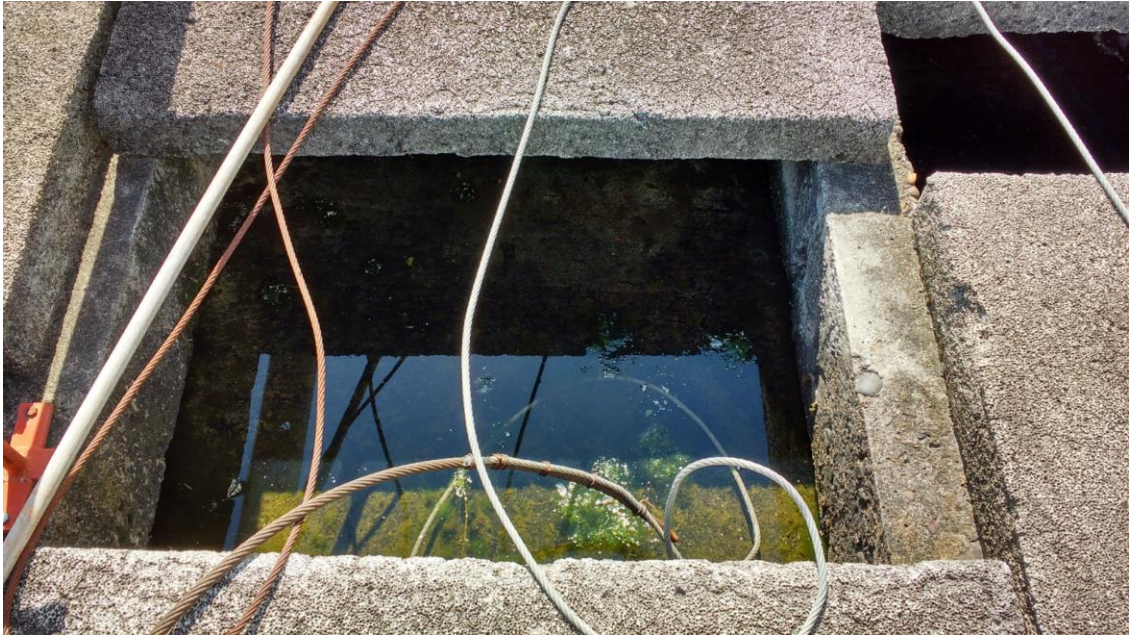
Figura 13-2: Acúmulo de água na laje de cobertura provavelmente devido ao entupimento das descidas de água pluvial.
