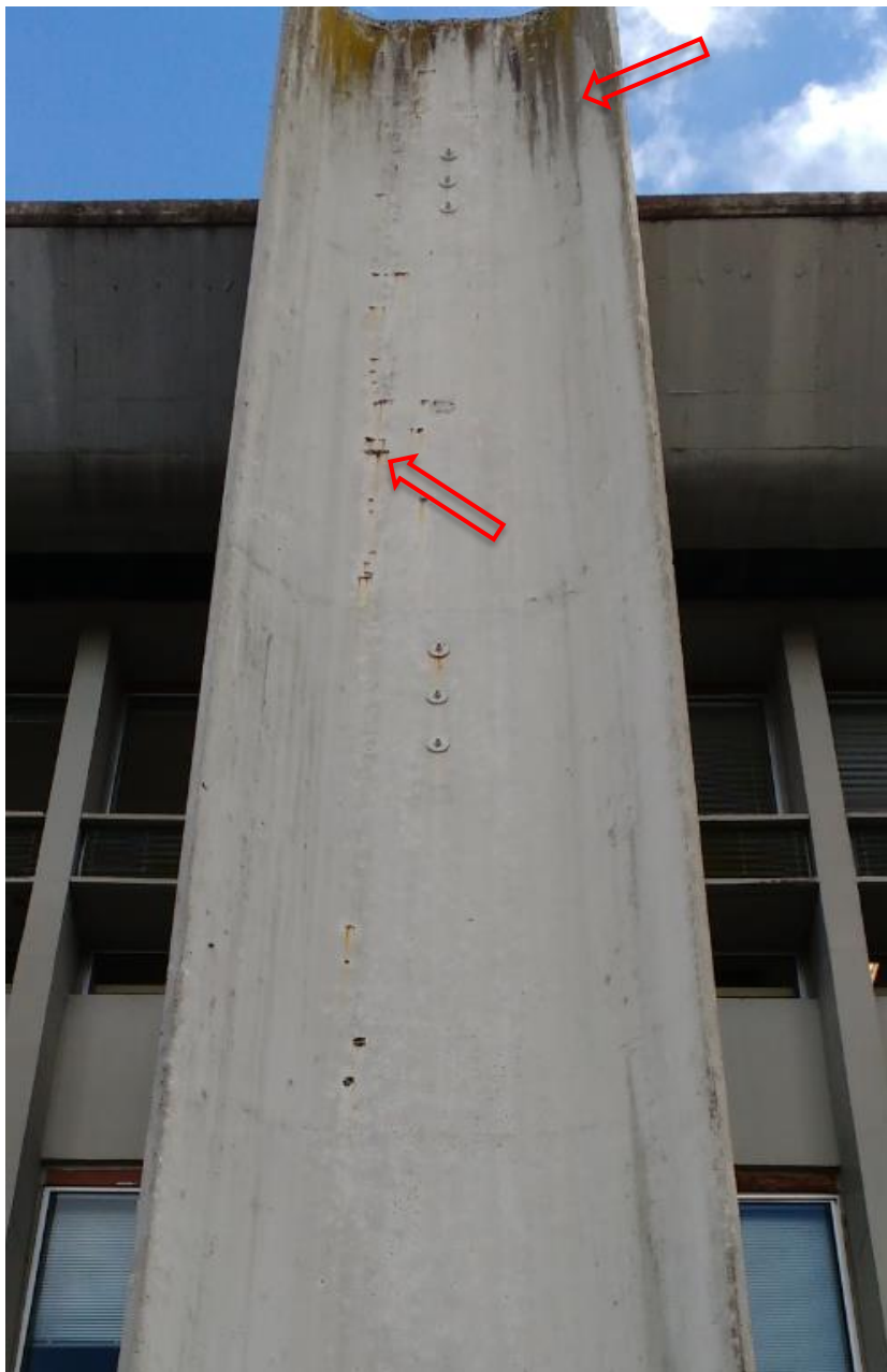
Figura 16-1: armaduras expostas e manchas devido à ação do tempo
