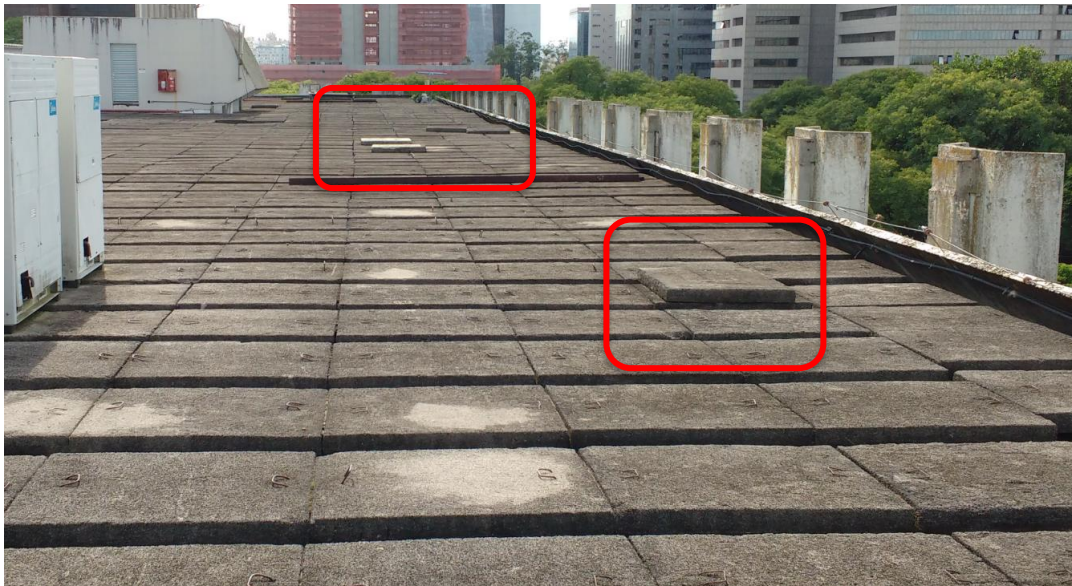
Figura 17-1: placas pré-moldadas da cobertura fora da posição.
